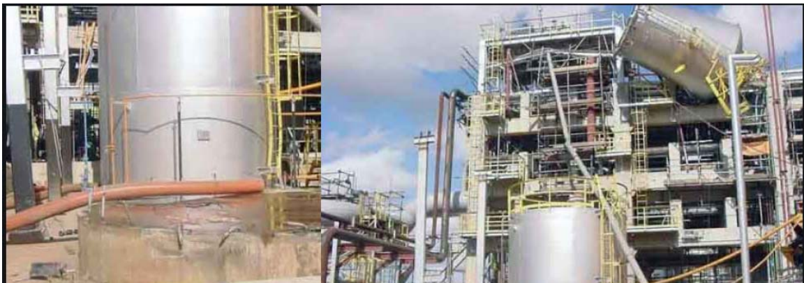
شکل-۹۶: تخریب در هنگام تست نیوماتیک در مخزن ذخیره ای
