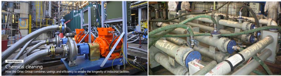
شکل-۴۸: تمیزکاری داخلی لوله با استفاده از مواد شیمیایی تحت عنوان Pickling
