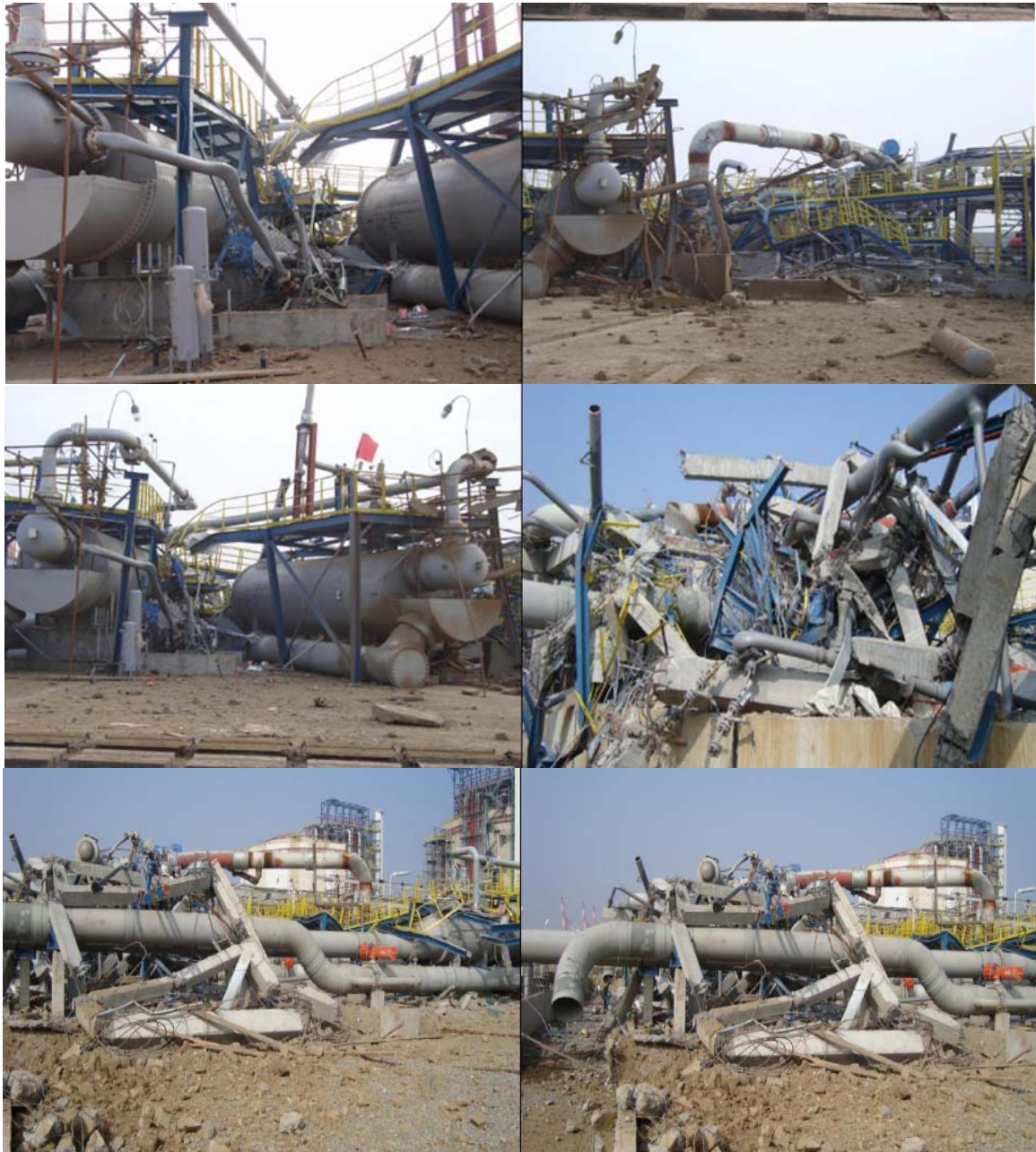
شکل-۹۲: خرابی های ناشی از انفجار تست هوا در لوله 36" روزمینی
